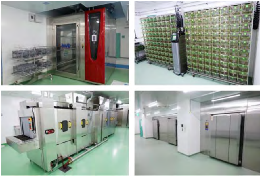
2020 年センター改修・増築工事後（新たに設置された最先端設備の一部）
