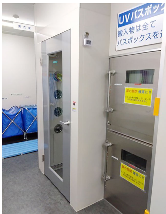
写真5-2 UVパスボックスとエアシャワー
