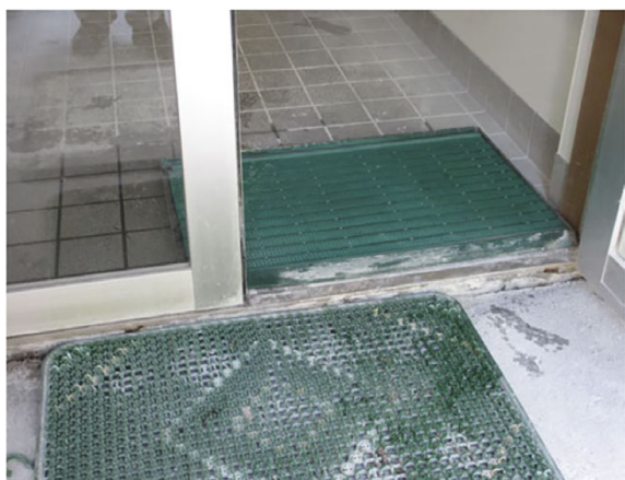
図3 玄関口での踏み込み槽
